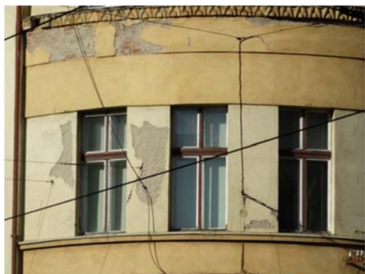
Fig. 6., 7., 8. Palatul Urania. Detaliu din zona cornișei decorate în relief plat, grav afectată de infiltrațiile de umiditate (stânga) și vedere generală asupra etajelor superioare, cu tencuielile originale afectate de expunerea la factorii de mediu și de instalarea la vedere a cablurilor de diferite tipuri.
